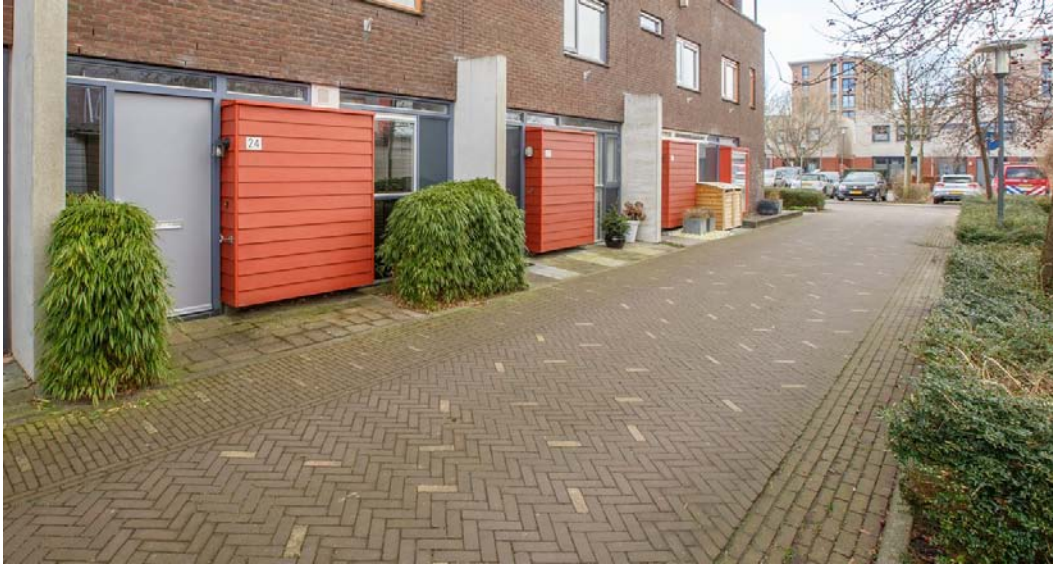
Figuur 9: Voorbeeld van een straatinrichting in Poelgeest waar tijdens piekbuien water snel de woning in kan stromen.
